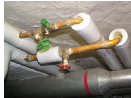
Unzureichend gedämmte Heizungsleitungen
